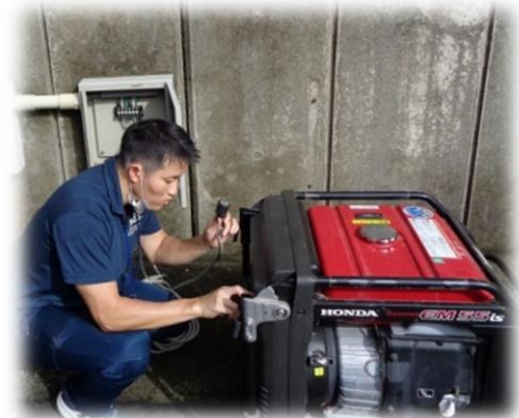
非常用発電機の作動訓練
